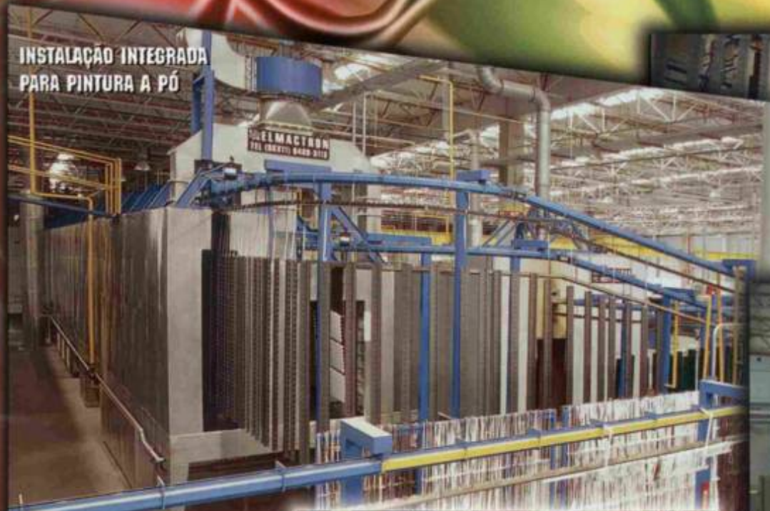
CABINA DE PINTURA COM RECÍPROCADOR E CICLONE
