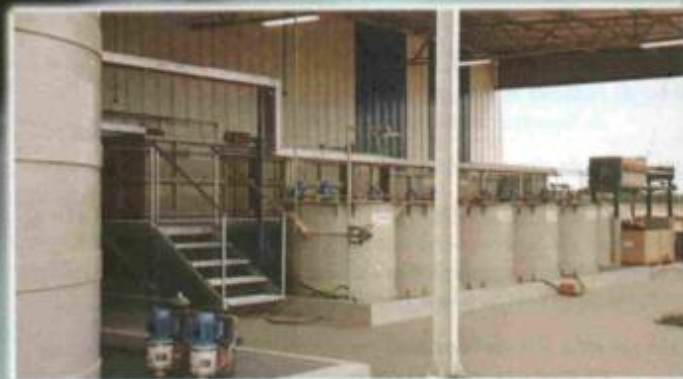
E.T.E.s. para 10m 3 /h (fosfatização com pintura cataforética)
