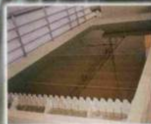
Clarificador lamelar contínuo em polipropileno
