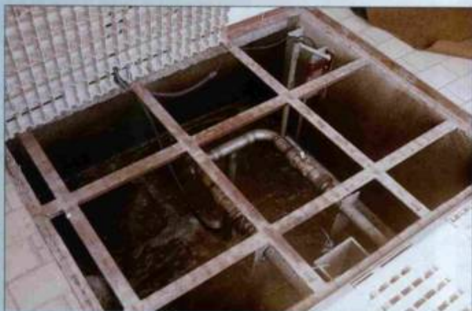
Tanque de distribuição
