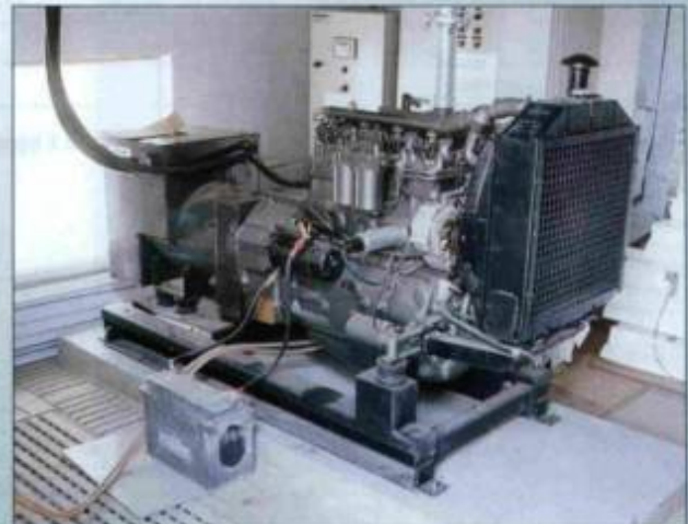
Gerador de energia
