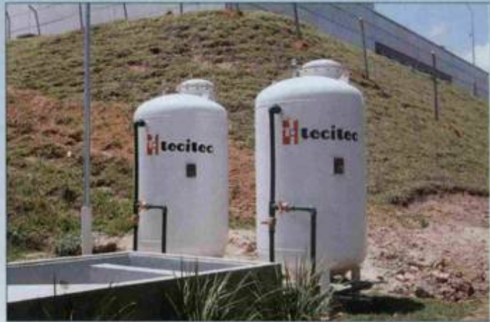
Filtros de areia
