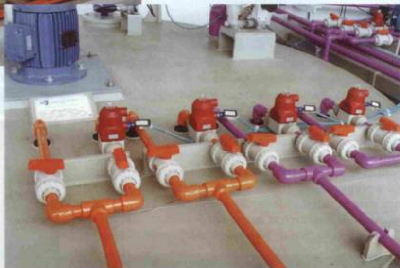
Detalhe de válvulas automáticas de dosagem de reagentes
