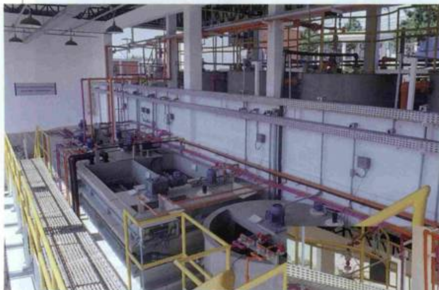
Acima, estação compacta e tanque de controle final
