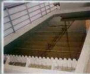
Clarificador lamelar contínuo em polipropileno
