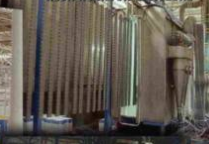
CABINA DE PINTURA COM RECIPROCADOR E CICLONE
