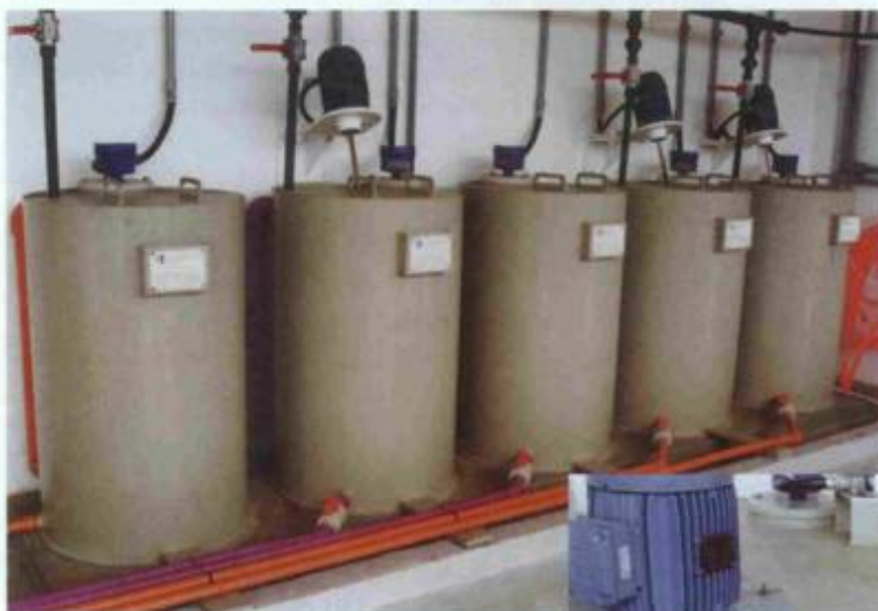
Acima, tanques de preparo de reagentes
