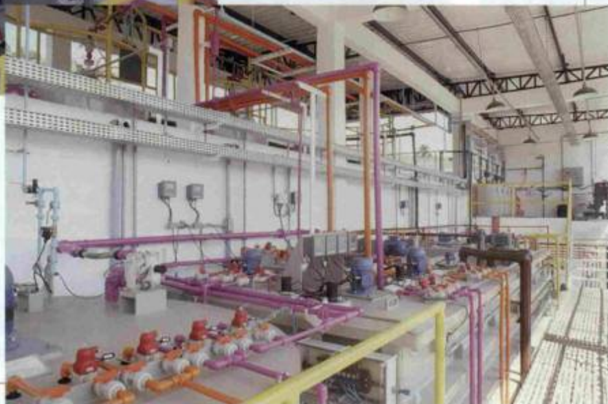
Ao lado, tanque de tratamento de complexantes
