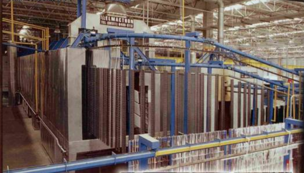
INSTALAÇÃO INTEGRADA PARA PINTURA A PÓ
