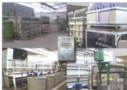
ETE garante qualidade dos efluentes tratados
