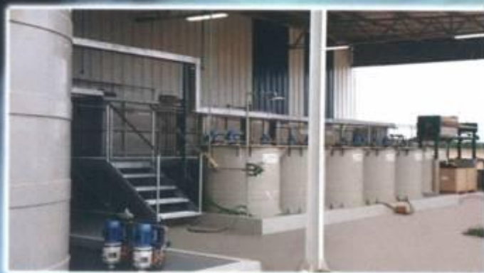
E.T.Es. para 10m³/h (fosfatização com pintura catódica)
