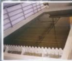
Clarificador lamelar contínuo em polipropileno
