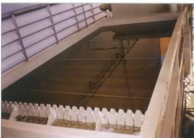
Unidade de decantação
