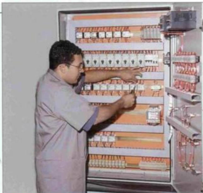
Painel de comando elétrico
