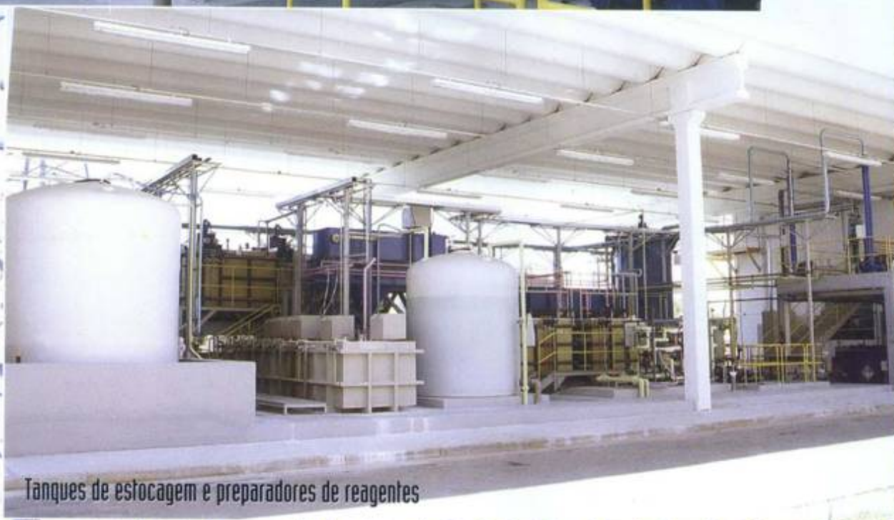
Estação de conceito misto contínuo e batelado
