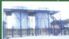
Estação de tratamento de esgoto por batelada
