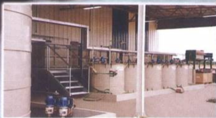
E.T.E.s. para 10m 3 /h (fosfatização com pintura catódica)
