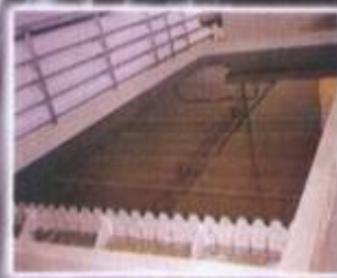
Clarificador lamelar contínuo em polipropileno
