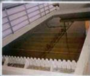
Clarificador lamelar contínuo em polipropileno
