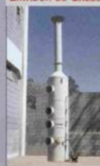
LAVADOR DE GASES
