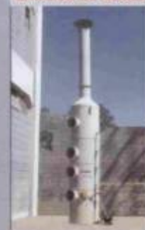
LAVADOR DE GASES
