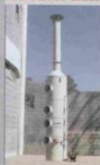
LAVADOR DE GASES
