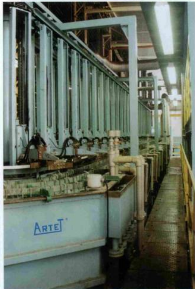
Visão geral do novo equipamento automático
