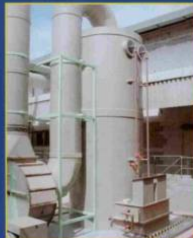
Lavadores de gases
