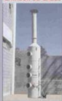
LAVADOR DE GASES
