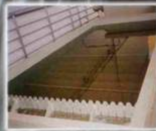
Clarificador lamelar contínuo em polipropileno
