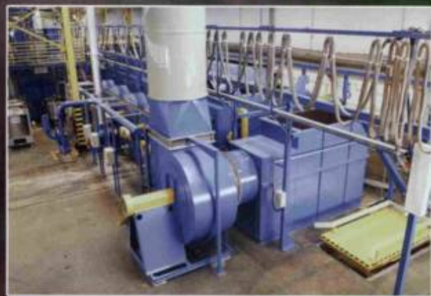
ELEVADOR DE CARGA/DESCARGA, RESFRIADOR DE PEÇAS PINTADAS E ESTUFA DE CURA
