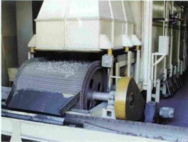
Equipamento para a etapa de cura dos banhos da Metal Coatings Brasil
