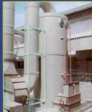
Lavadores de gases
