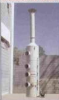
LAVADOR DE GASES
