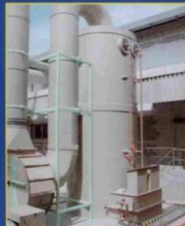
Lavadores de gases
