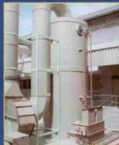
Lavadores de gases
