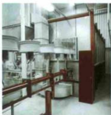
Cabine de pintura a pó primer
