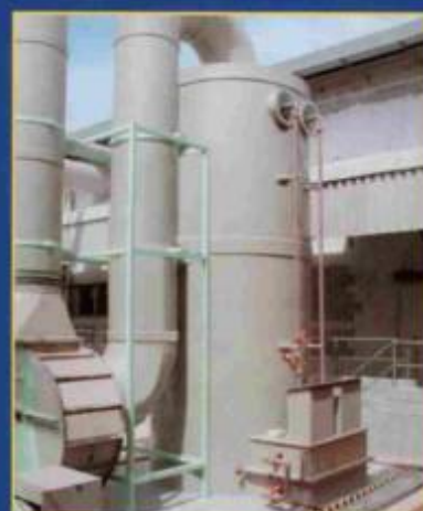
Lavadores de gases
