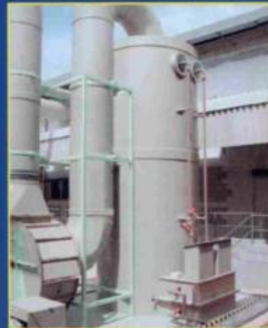
Lavadores de gases
