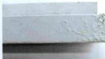
Foto 3: O perfil mais atacado e o aspecto da corrosão filiforme
