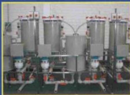
Conjunto de filtração
