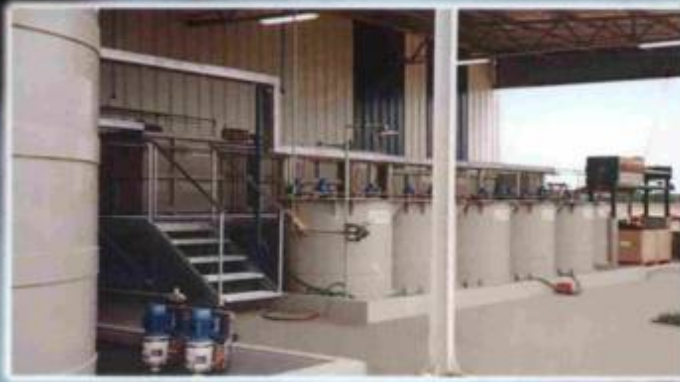
E.T.E.s. para 10m³/h (fosfatização com pintura catódica)
