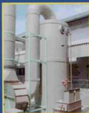
Lavadores de gases
