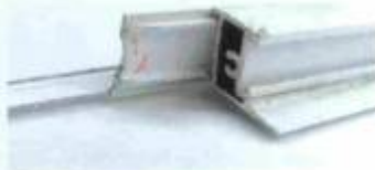
Foto 2: Os dois perfis encaixados mostrando onde ocorreu a corrosão
