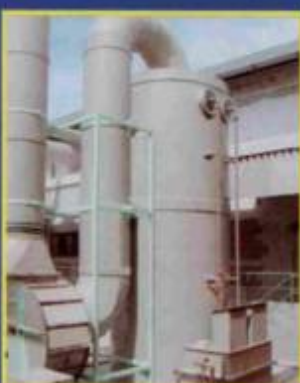
Lavadores de gases
