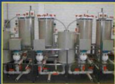
Conjunto de filtração
