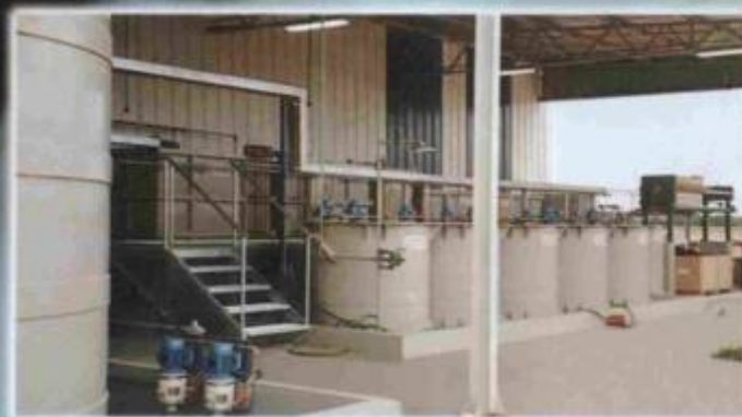
E.T.Es. para 10m 3 /h (fosfatização com pintura catafórica)
