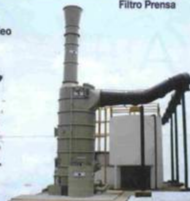
Lavador de Gases
