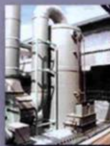
SISTEMAS DE EXAUSTÃO
