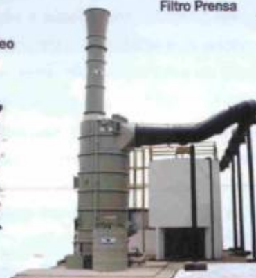
Lavador de Gases
