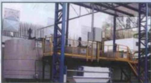
ESTAÇÃO DE TRATAMENTOS DE EFLUENTES
