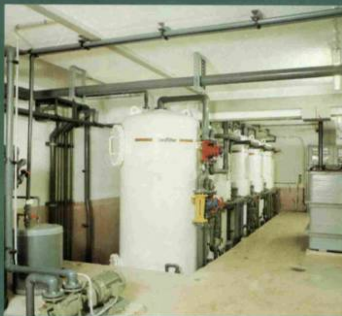
Sistema de desmineralização com trocadores de íons
