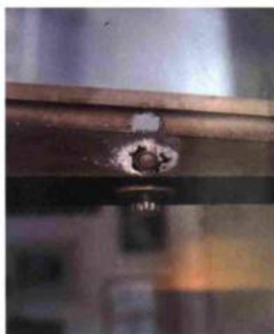
Corrosão por diferença de potencial
