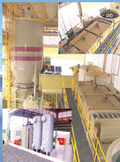
ETE - Estação de Tratamento de Efluentes Automáticas / Manuais
