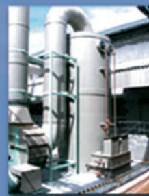
SISTEMAS DE EXAUSTÃO
