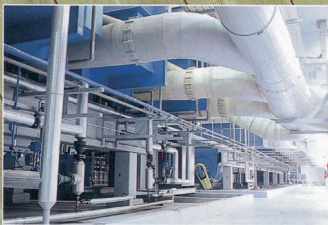
Exaustão de gases
