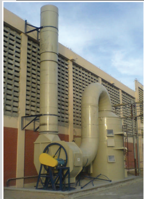
Sistema de Exaustão com Lavagem de Gases Vertical
