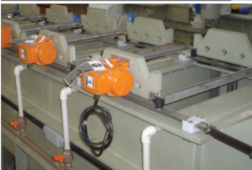
Equipamentos para Metalização
