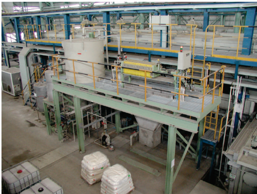
Sistema automático de filtração de borra do fosfato
