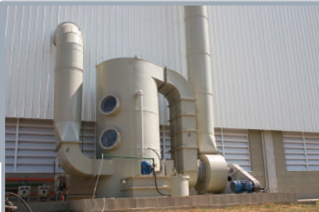
Lavador de gases
