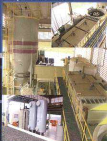
ETE - Estação de Tratamento de Efluentes Automáticas / Manuais
