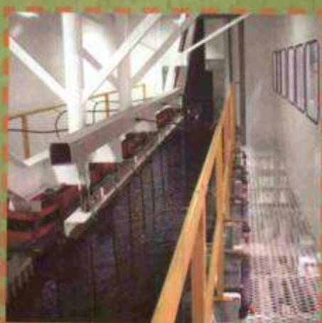
Tanque de tinta KTL enclausurado
