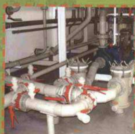
Sistema de recirculação de tinta
