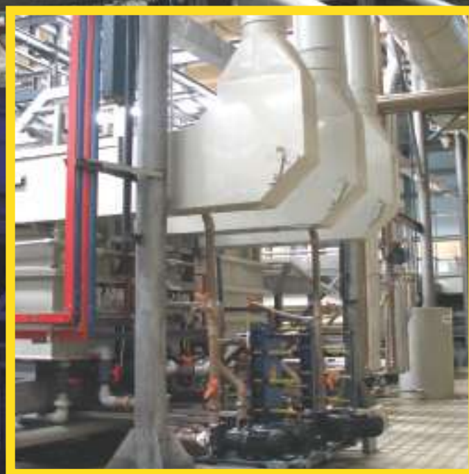
Sistemas integrados de refrigeração
