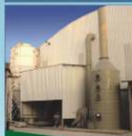
LAVADOR DE GÁS
