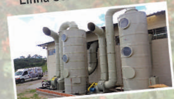
Lavadores de Gases
