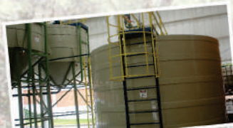
Tanques de Armazenagem e Decantação
