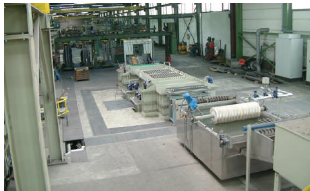
Planta de decapagem eletrolítica com fosfatização de cálcio instalada após um forno de recozimento com 24 arames
