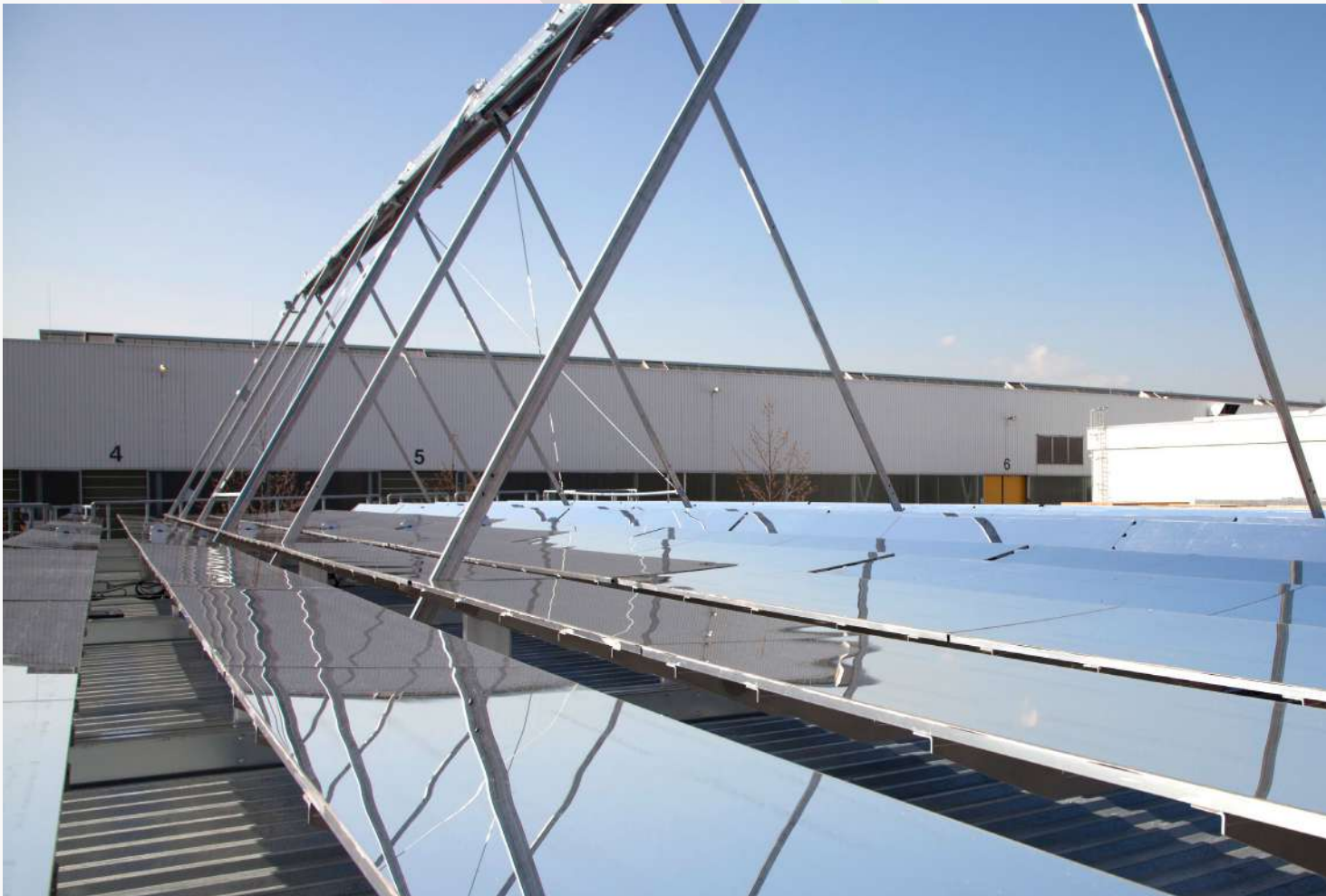
Foto 1: A Dürr usa a energia do sol para aquecer os fornos na cabina de pintura
