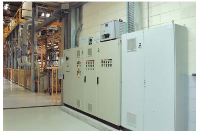
Foto 6: Painel de automação
