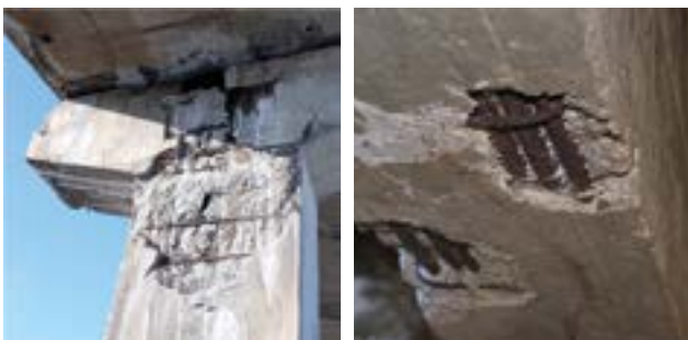
Figuras 2 e 3: Efeito da corrosão nas armaduras de aço dentro do concreto
