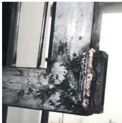
Figura 1 - Antes do tratamento
