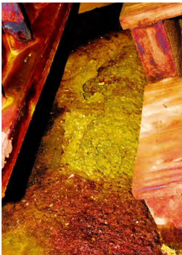
Foto 1 - Evidência de contaminação por permeação de solo com cromo em instalação galvânica.
