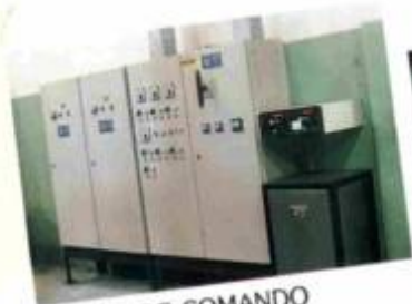
PAINÉIS DE COMANDO
