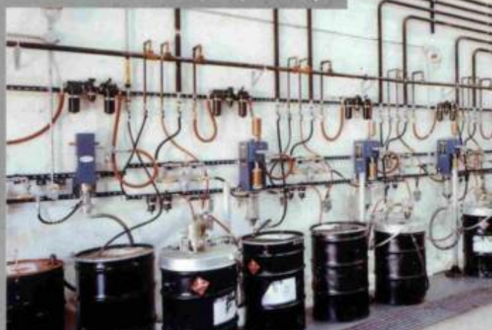
Centrais de abastecimento de tinta
