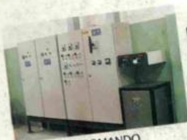
PAINÉIS DE COMANDO
