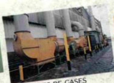
LAVADORES DE GASES
