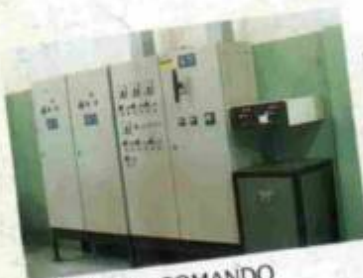
PAINÉIS DE COMANDO
