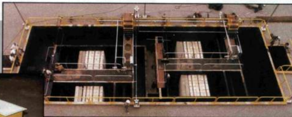
Separador de água/óleo construído em tanque de concreto com vazão de 450 m 3 /h. Oil/Water Separator assembly in concrete pit, rated for 450 m 3 /h.
