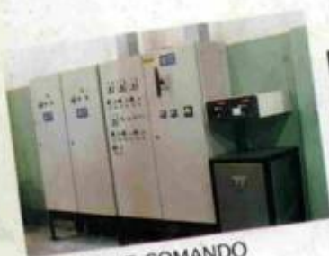
PAINÉIS DE COMANDO
