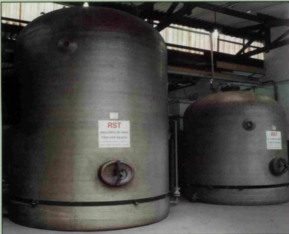
RESERVATÓRIO DE EFLUENTES
