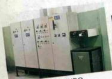
PAINÉIS DE COMANDO
