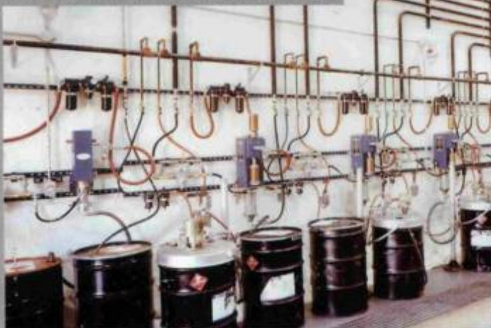
Centrais de abastecimento de tinta
