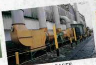
LAVADORES DE GASES
