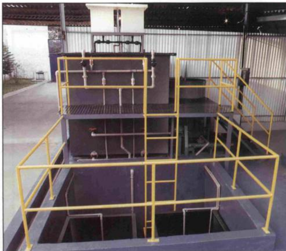
ESTAÇÃO DE TRATAMENTO
