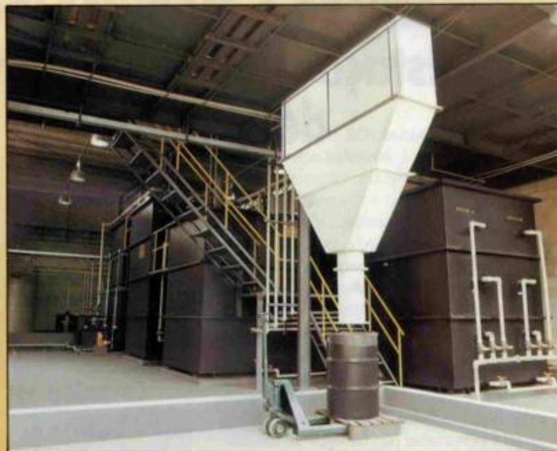
Estação de Tratamento de Efluentes
