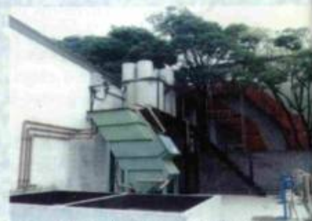
Estação de Tratamento de Efluentes instalada na Transbrasil S.A.
