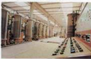
Detalhe da "Instalação a Descarga iônica" com capacidade de 56 m 3 /hora do tipo à "Seções Separadas"
