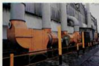
LAVADORES DE GASES
