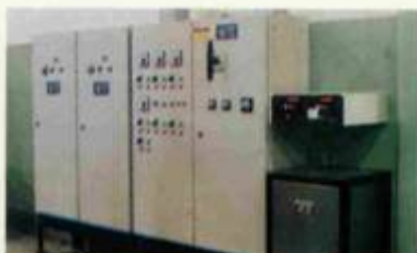
PAINÉIS DE COMANDO
