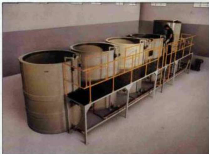
Estação Compacta de Tratamento Cromo
