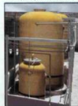
Tanques para Armazenamento de Concentrados
