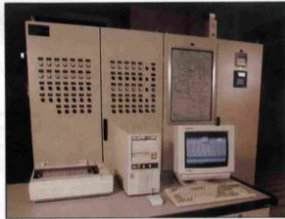
Sistema de Automação para Gerenciamento completo de pH - ORP - FLUXO
