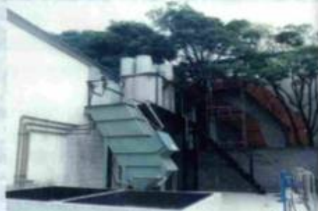
Estação de Tratamento de Efluentes instalada na Transbrasil S.A.
