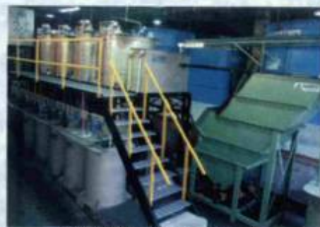
Estação de Tratamento de Efluentes instalada na Fechaduras Brasil Ltda.
