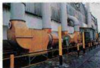
LAVADORES DE GASES
