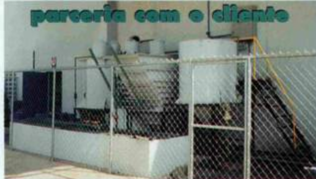
E.T.E instalada na ATLAS COPCO BRASIL LTDA.
